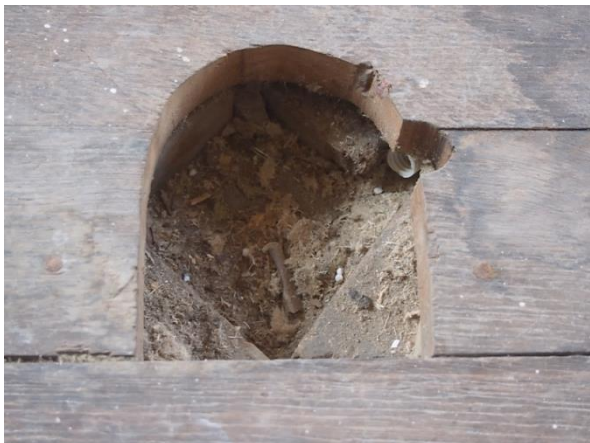
Afb. 35: Schade in plankenvloer door onzorgvuldig en destructief treffen van voorzieningen.
