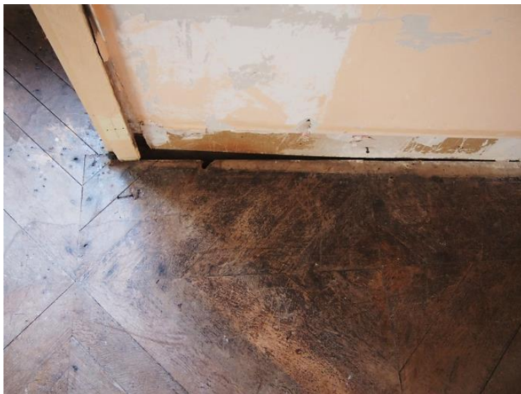
Afb.21: Detail aansluiting parket met wand. Na het demonteren van een vloerplint zijn er verschillende aandachtspunten: bijvoorbeeld verzorgen van bescherming van de vloer, ventilatie van de ruimte onder de vloer of de behandeling van houtaantasting dat bij een gunstige temperatuur is ontstaan doordat er bij het dweilen van de vloer water onder de plint terecht komt, hier achterblijft en onvoldoende opdroogt.
