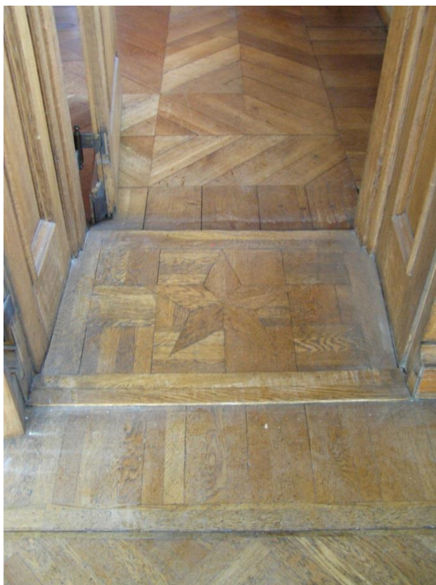
Afb.29: Detailfoto van een doorgang in een interieur waar verschillende parketvloeren en patronen samenkomen.
