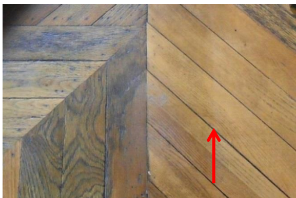
Afb. 13: Lichtschade, met aftekening tapijtrand.
