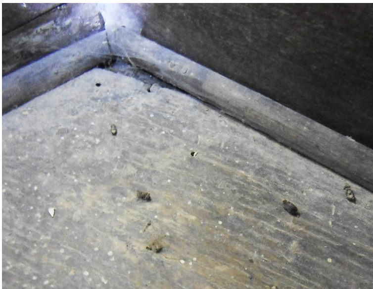
Afb.23: Detail van een plankenvloer met aan weerszijden een houten lambrisering. In de vloer zijn uitvliegopeningen zichtbaar van de spinthoutkevers. Enkele exemplaren zijn dood aangetroffen, waardoor het hier niet om een oude activiteit lijkt te gaan.
